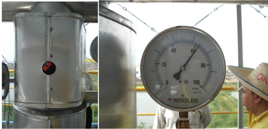
รูปที่ 7.10 ตำแหน่งการเปิดวาล์วและค่า Head ของเครื่องสูบน้ำเย็น (หลังปรับปรุง)
