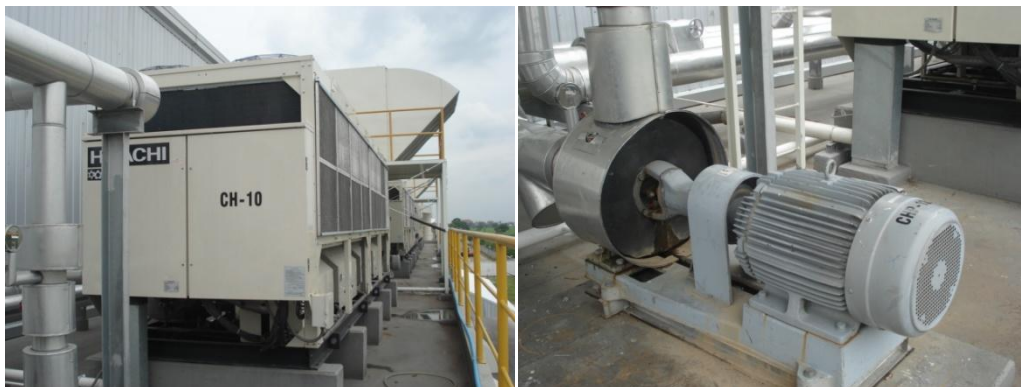
รูปที่ 7.8 เครื่องทำน้ำเย็นและเครื่องสูบน้ำเย็นที่ติดตั้งใช้งาน
