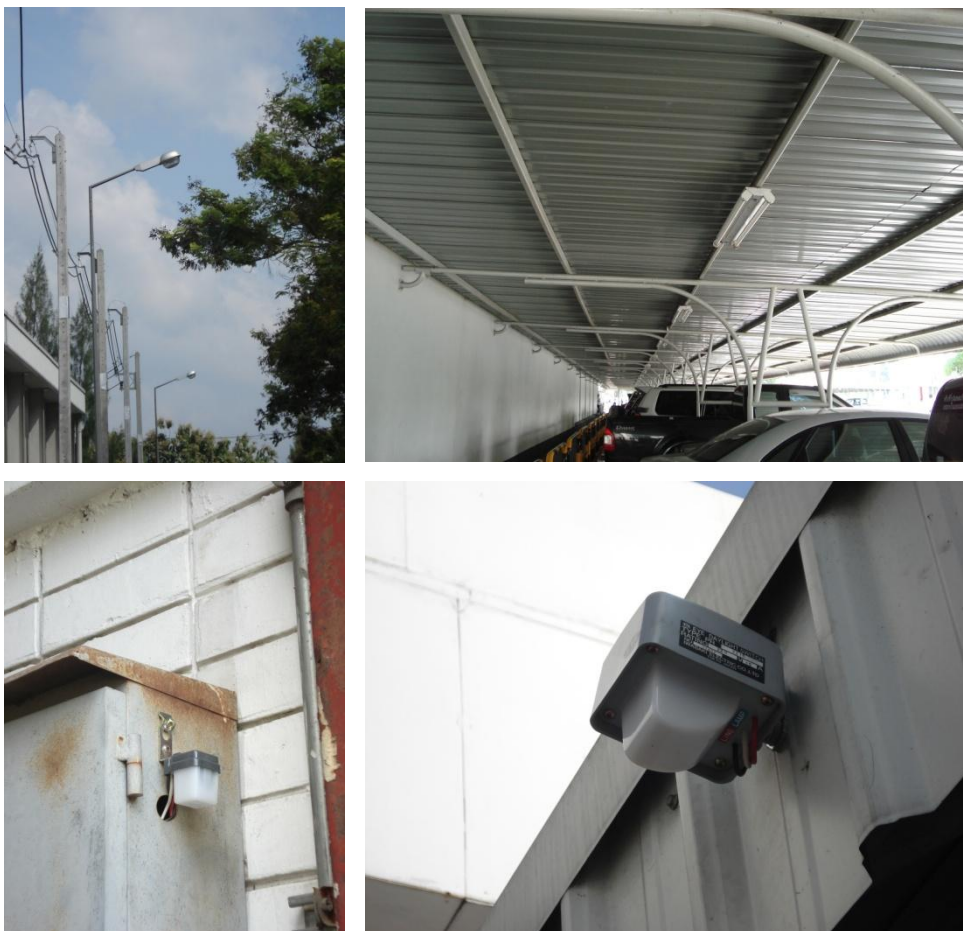
รูปที่ 3.16 การติดตั้ง Photo Switch เพื่อควบคุมแสงสว่างภายนอกอาคาร
